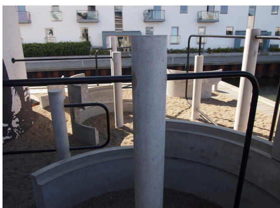
Rør støbt ind i betonsøjle, StreetDome, Haderslev
