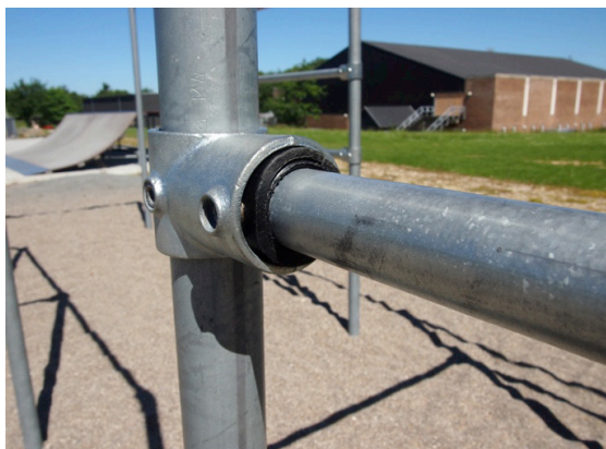
Rørsamling med clamp, Thisted Multipark
